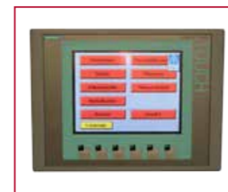
Siemens S7 PLC
